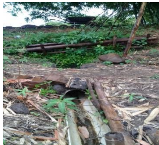
Gambar 6. Plompong atau Jalan air keluar
